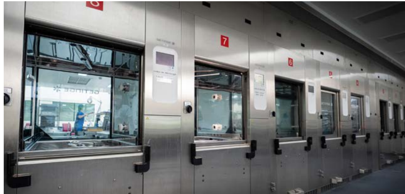
MUR TECHNIQUE DE LAVEURS DÉSINFECTEURS D'INSTRUMENTS
